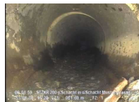
Monitoring von Wasser- leitungen/ Abwasserkanälen
